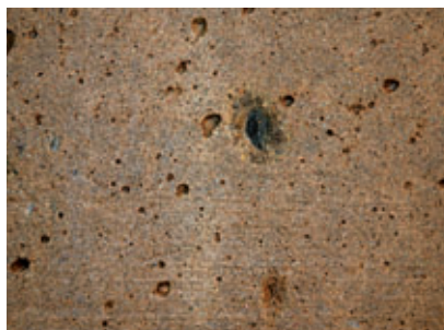
Abb. 3a: Die Oberfläche des Behälters zeigte regelmäßige Abplatzungen, die durch quellfähigen Tonschiefer als Zuschlagstoff im Beton entstanden.
