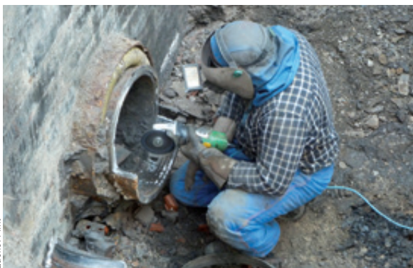
Abb. 4: Die alten Rohrleitungen aus Stahl wurden entfernt bzw. gekappt und als Wanddurchführung für die neuen Edelstahlrohre verwendet.
