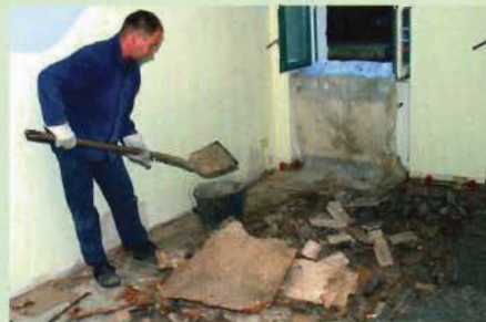
Abb. 3: Sämtliche organische Bestandteile im Befallsbereich müssen ausgebaut werden.
