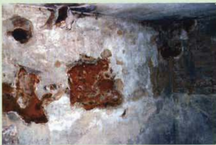
Abb. 1: Fruchtkörper des Echten Hausschwamms an einer Kellerwand aus Beton.
