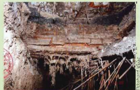
Abb. 6: Holzbalken der Treppe von unten dargestellt. Die Tragfähigkeit ist nicht mehr vorhanden.
