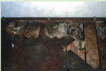
Abb. 2: Das flächige Myzel des Echten Hausschwamms hat bereits den Parkettfußboden im Erdgeschoss unterwachsen.
