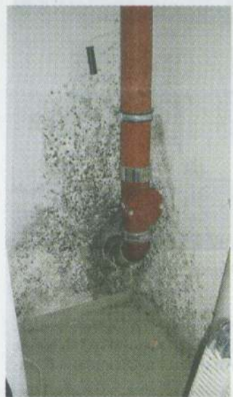
Klarer Fall: Feuchte Wand im Keller mit Schimmelbildung.
