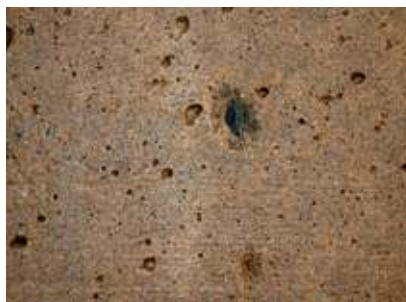
Abb. 3a: Die Oberfläche des Behälters zeigte regelmäßige Abplatzungen, die durch quellfähigen Tonschiefer als Zuschlagstoff im Beton entstanden.
