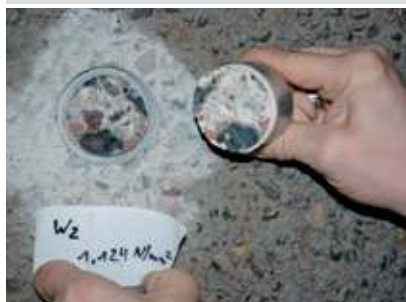
Abb. 3b: Die Prüfwerte für die Haftzugfestigkeit der alten Oberfläche bewegten sich unter 1,5 N/qmm, sodass sie konstruktiv neu aufgebaut werden mussten.
