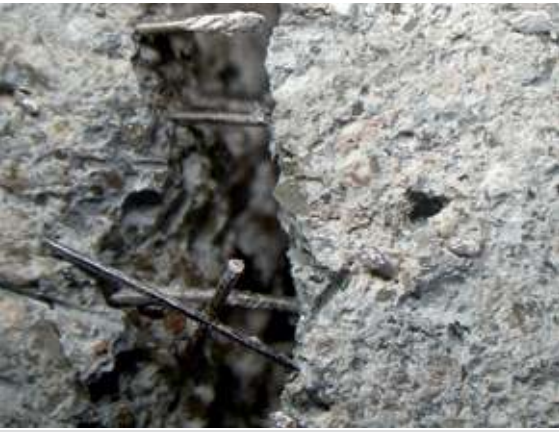
Abb. 4 a: Dreidimensionale Verteilung der Edelstahlfasern im Riss der Mörtelmatrix eines Probekörpers nach einem Biegezugversuch
